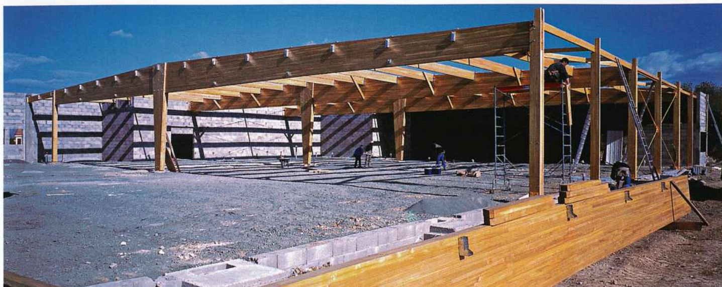
Chantier de l'Intermarché à Marans (Charente-Maritime). Charpente en peuplier réalisée par les Établissements FOURNIER à Poiré-sur-Vie (Vendée). Cliché BRUMAIRE
