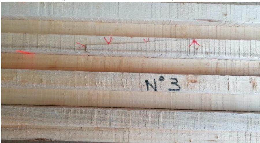
Figure 65: Photo des différentes fissures suite à rupture de la dalle 3
